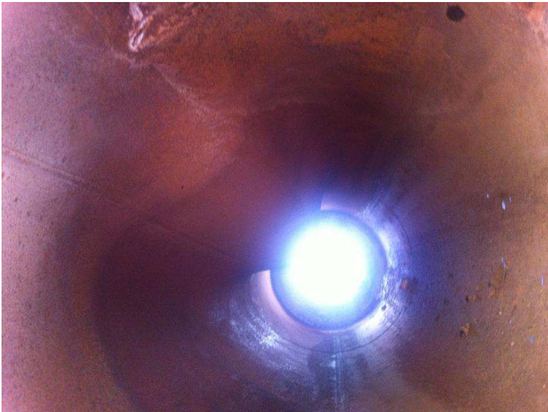
Figure II.14 : Hernie formée sur une ancienne chaudière allemande du client.
