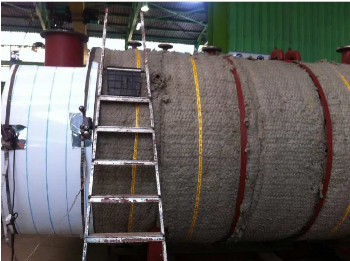
Figure II.11 : Revêtement de la chaudière.
