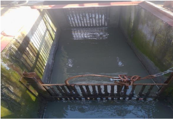
Figure 6 : Dégrilleur fin manuel
