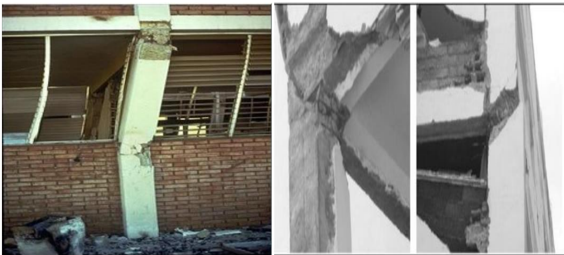
Figure II.2 : Cisaillement des poteaux par les bielles développées dans la maçonnerie (séisme de Boumerdes 2003) [10].
