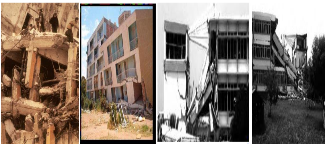
Figure II.9 : Effondrement partiel d'un bâtiment faute de mauvaise conception (séisme Boumerdes2003) [10]
