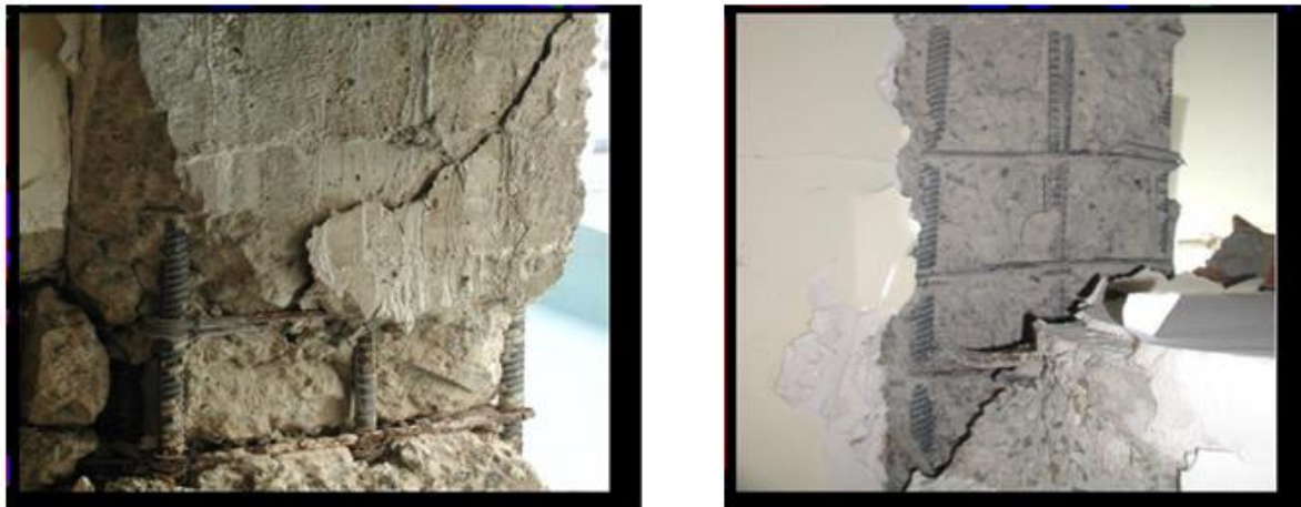
Figure II.11 : Éclatement du béton d'enrobage au niveau des zones nodales [10].
