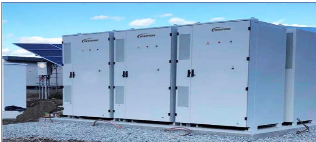
Fig. III.11 : Batterie de stockage de 233 kWh en lithium
