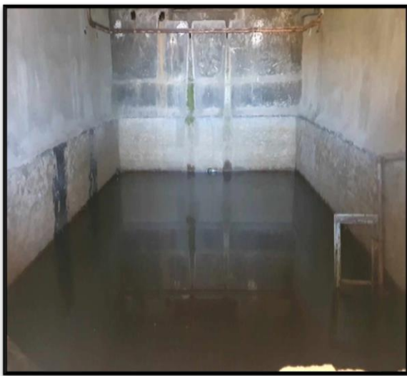
Photo 67 : Bâche à eau.
