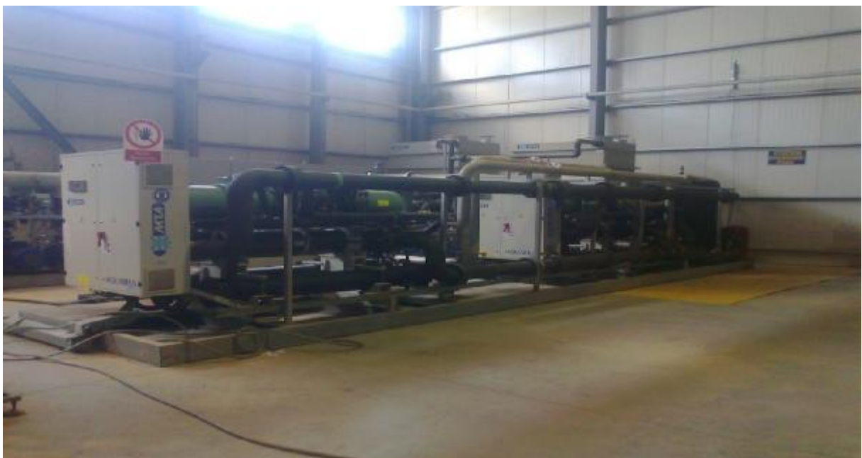
Fig.I.13 : Station de refroidissement pour l'unité verre à couche
