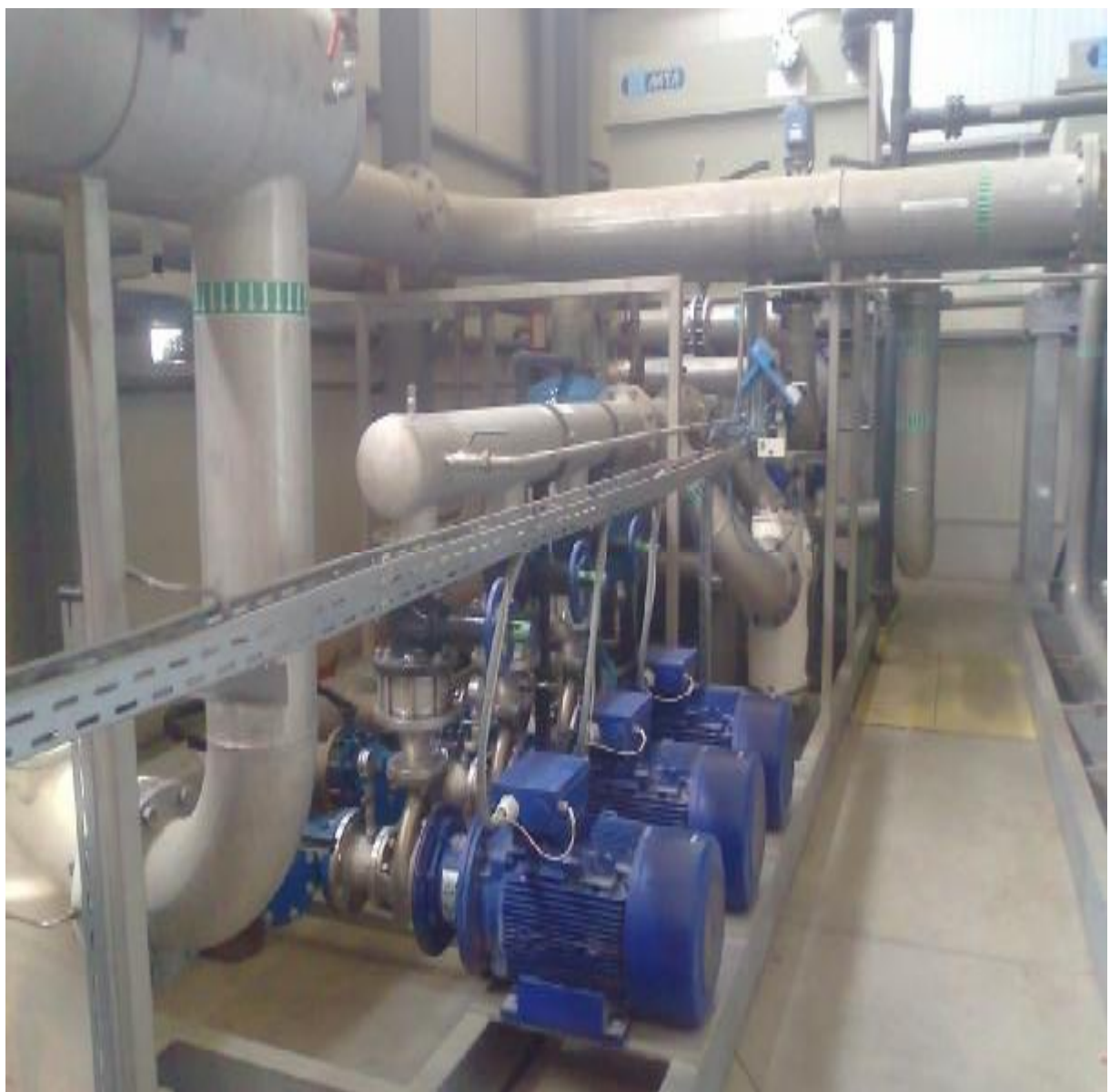
Fig.I.14 : les pompes de refoulement de la station
