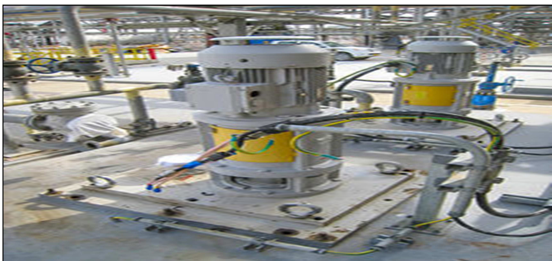
Figure I.8. Station de pompage d'un Oléoduc
