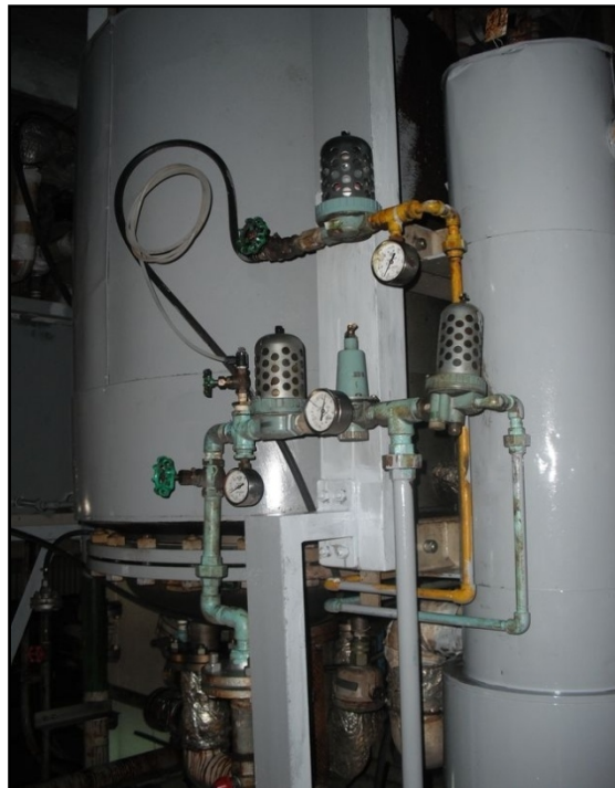
Figure III.24. Réservoirs des produits R et P dans la salle MPU
