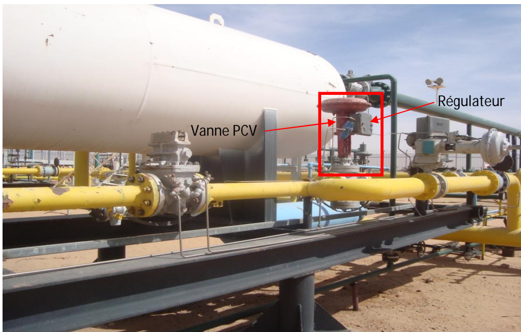
Figure II.7 : La vanne PCV avec le regulateur pneumatique.
