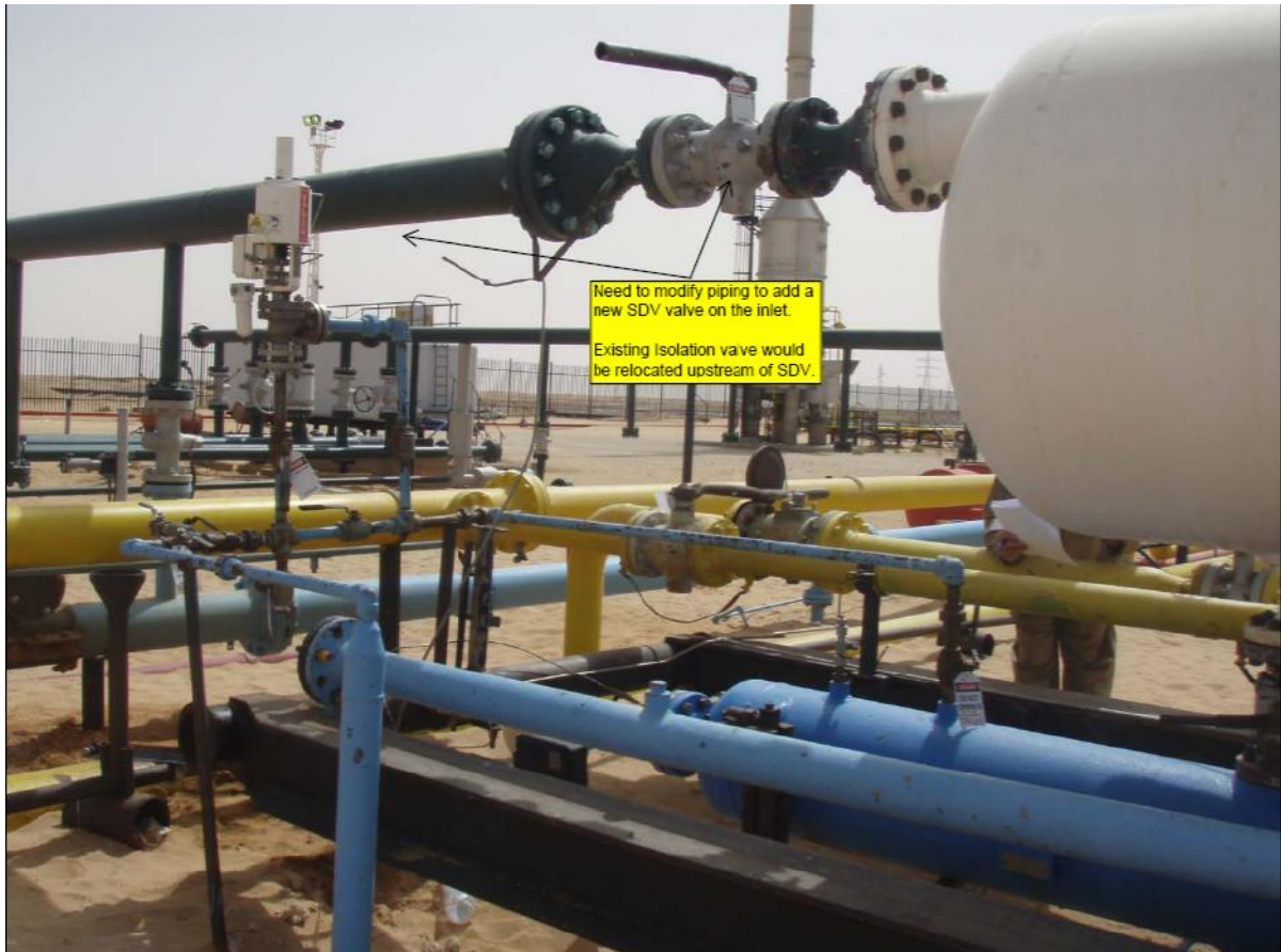
Figure II.8 : Vanne manuelle à l'entrée du séparateur.
