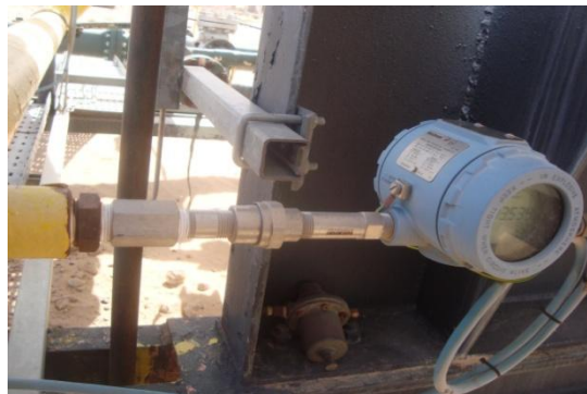
Figure III.5 : Transmetteur de température TT-11208.
