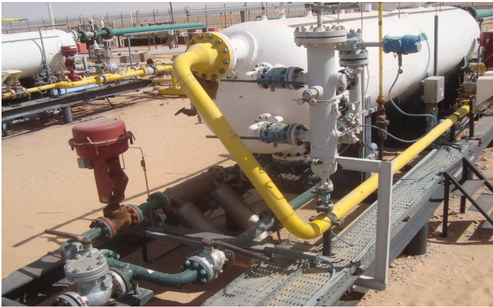
Figure III.1 : Installation d'un cylindre avec switches.
