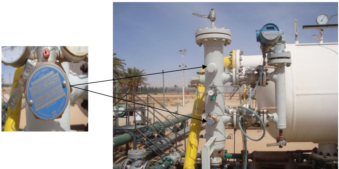
Figure III.3 : a/Transmetteur de niveau LT-11208 b/les switches LAH, LAL
