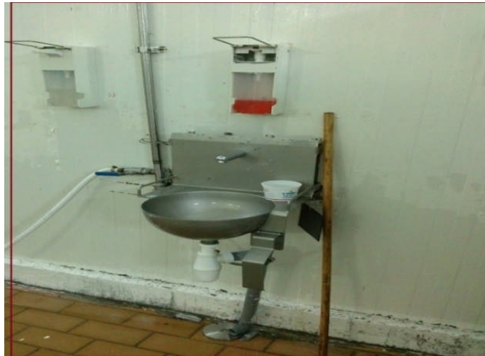
Figure N° 39 : Poste de lavage des mains.
