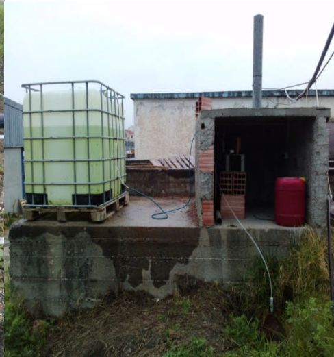
Figure N° 36: Bâche à eau.
