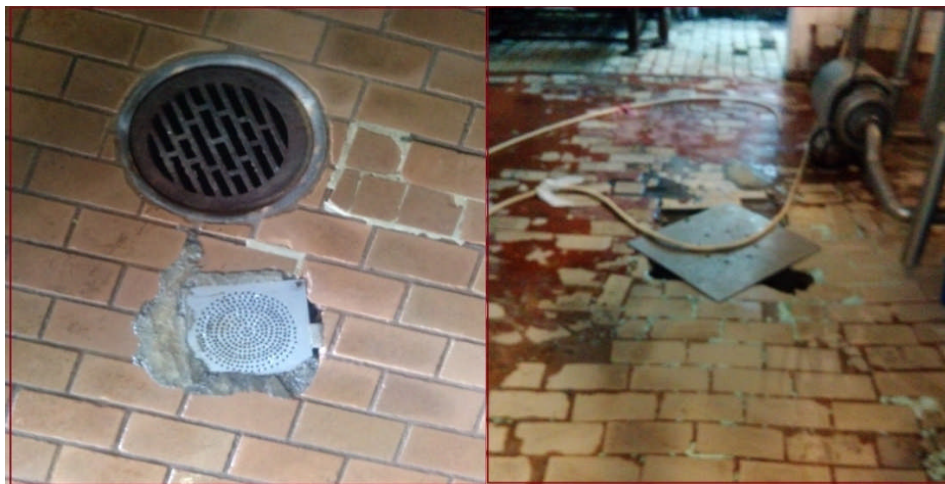
Figure N° 32: Siphons de la salle de fabrication.
