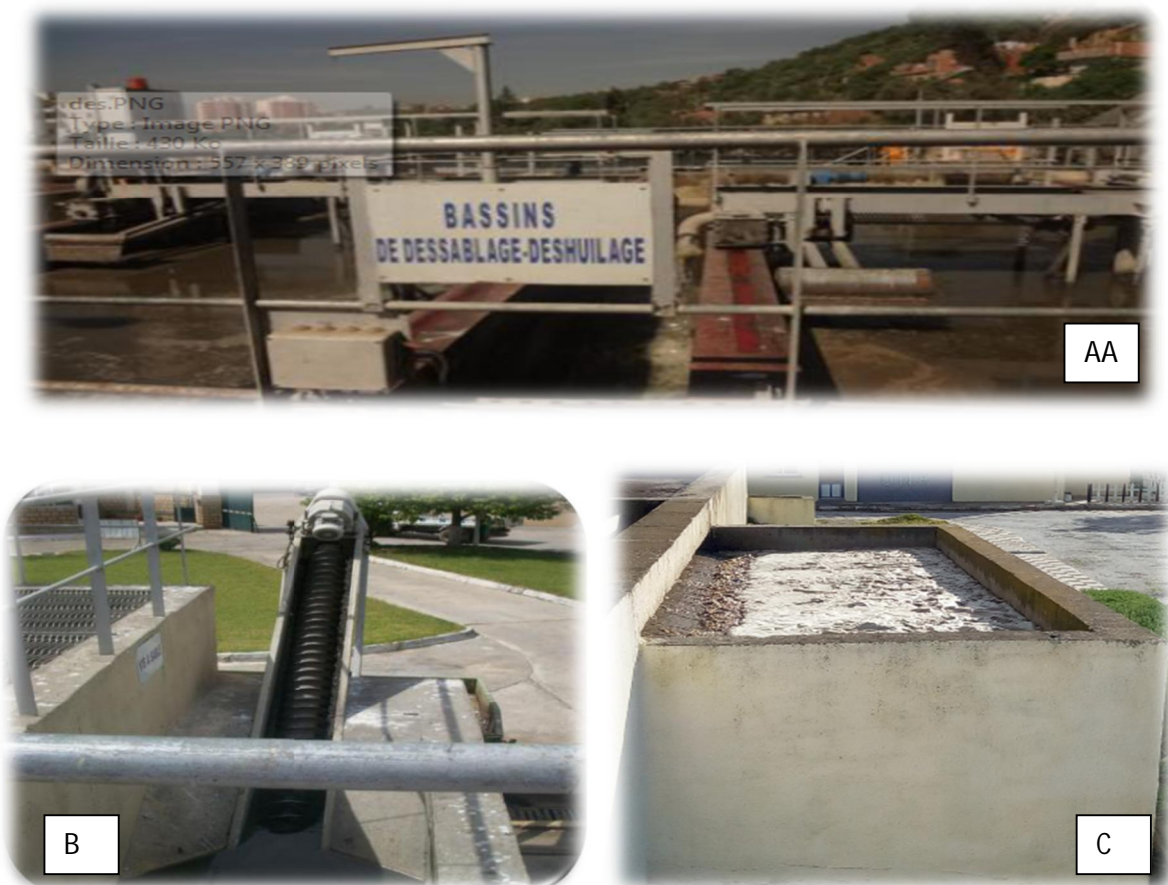
Figure 5 : Etape de déshuilage et dessablage
