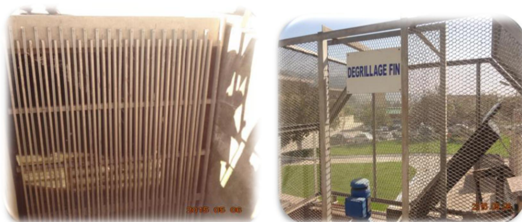
Figure 4 : Etape de dégrillage.
