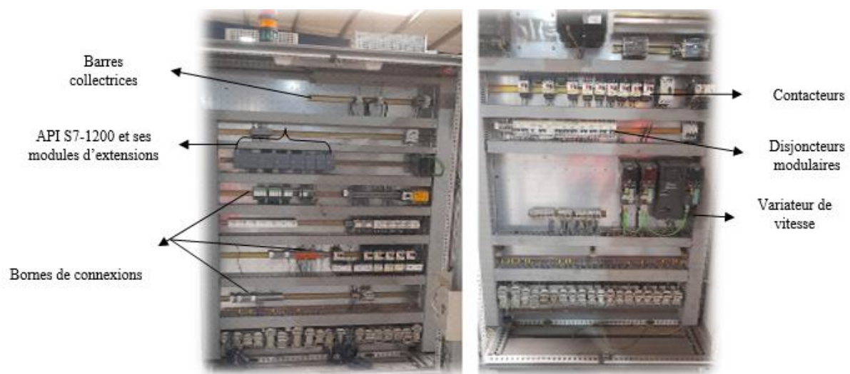
Figure. I.12 : Armoire électrique de la machine
