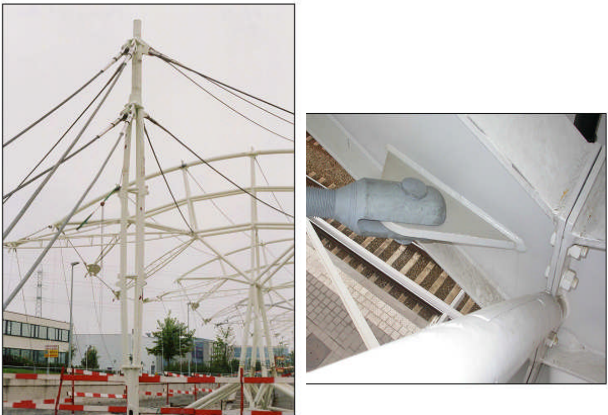
Figure 1-1: Structure de la toiture suspendue de la station du métro Erasme à Bruxelles
