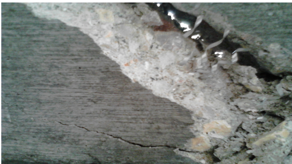
Figure VI.19 Mode de rupture d'une poutre testée montre les bords de la fissure qui sont reliés par les fibres
