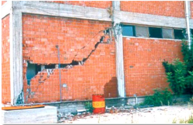
Figure I.16 Endommagement de remplissage causant le cisaillement des poteaux
