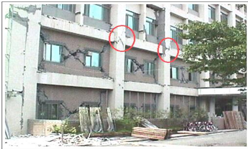
Figure I.14 La propagation des fissures diagonales vers les nœuds du cadre (remplissage assez rigide). Ces dégâts sont de degré 4
