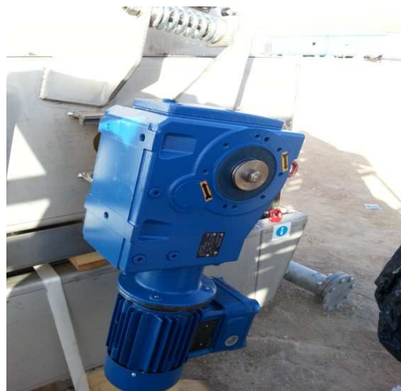
Figure (II.1) : Moteur du dégrilleur GVC
