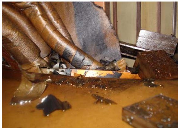
Fig.IV.4 Court-circuit dans les premières spires de l'enroulement MT (31,5KV), phase B.
