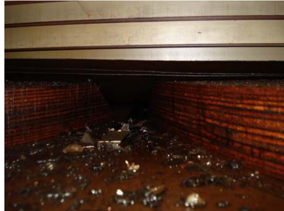
Fig.IV.2 Présence de débris de cuivre et papier brûlé dans la partie active.
