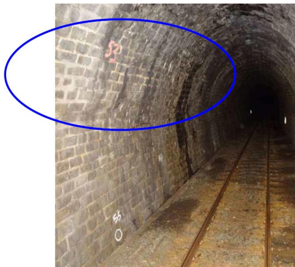
Figure II.16. Irrégularité en forme de bombement
