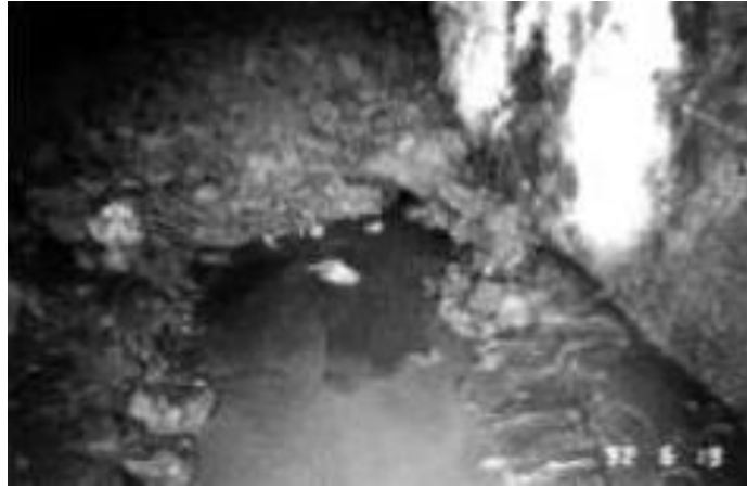
Figure II.6. Inondation du tunnel de Wushantou en Japon (1992)
