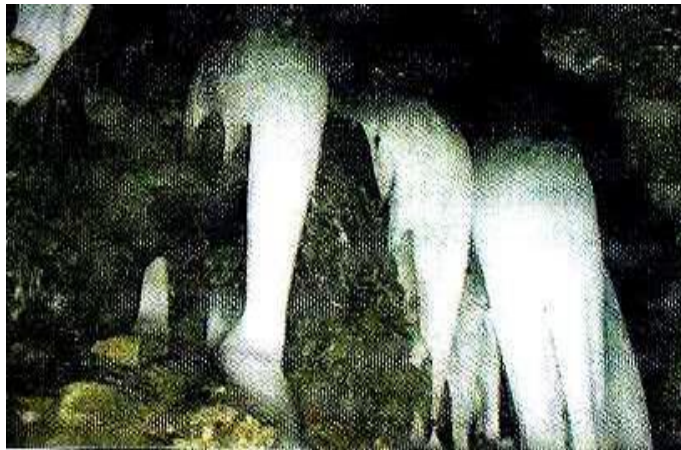
Figure II.5. Arrivée d'eau gelée dans le tunnel de Galibier
