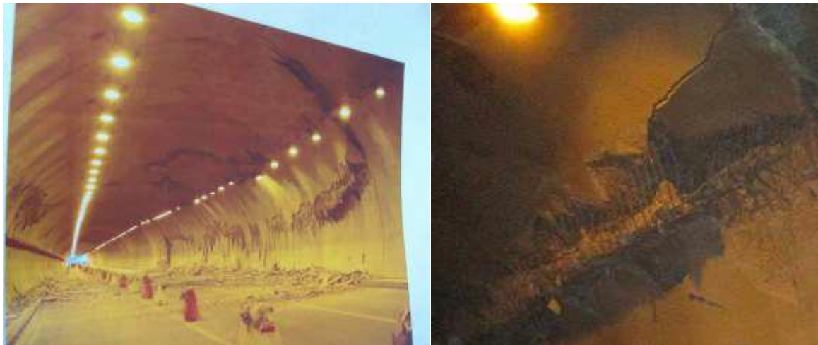
Figure IV.2. L'état de lieu de l'ouvrage après l'effondrement (L'endommagement de revêtement de tunnel gauche)
