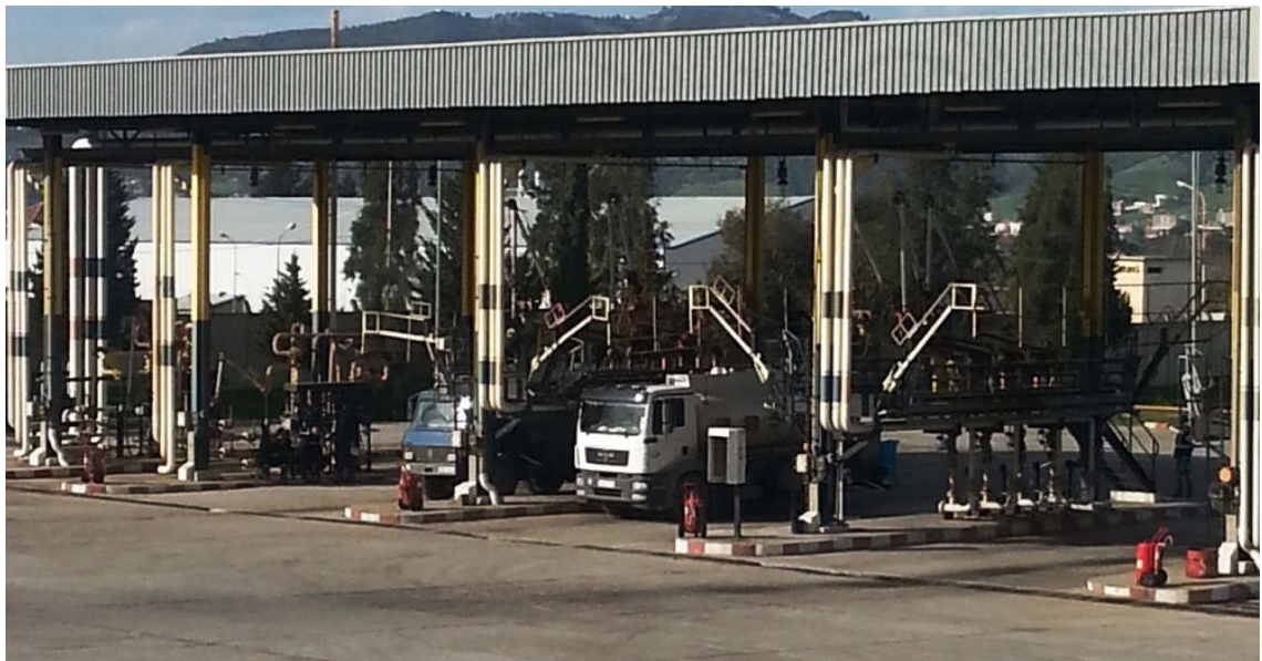
Figure I.2 : poste de chargement camions
