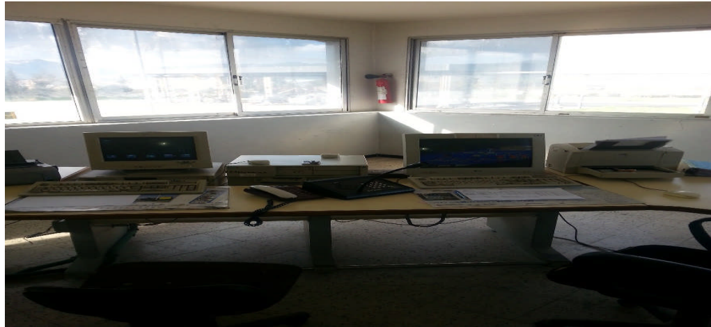
Figure I.4 : photo de la salle de contrôle.
