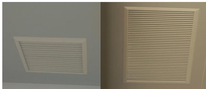
Figure IV. 9 : grille de repris dans un faux plafond Figure IV .10 : grille de repris dans un mur
