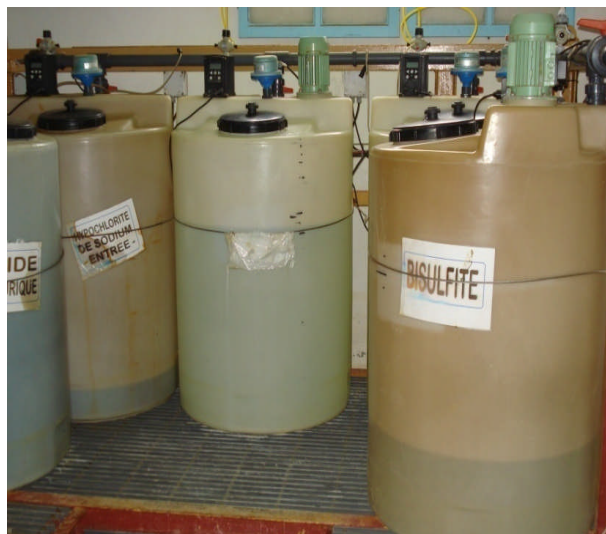
Figure II.2: Réservoirs d'acides de dosage
