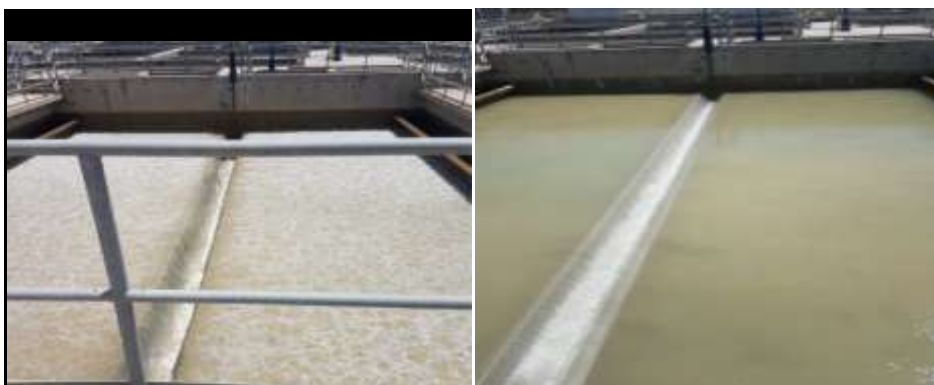
Figure 09: Filtres en état de lavage.
