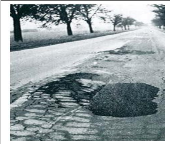
Figure II-7 : l'effet du gel sur les chaussées
