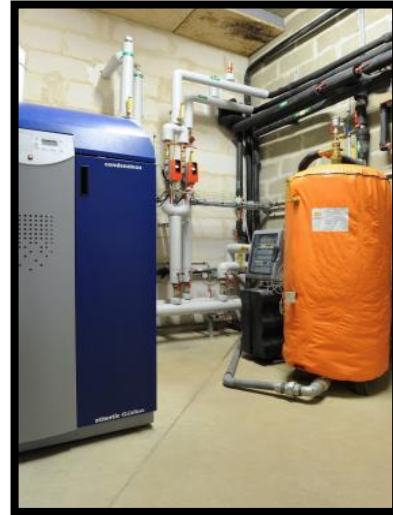
Figure 54 : vue sur la chaudière.
