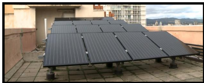
Figure 53 : Photo du panneau photovoltaïque. Source : www.travaux.fr
