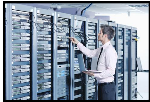
Figures 12: vue sur un serveur.
