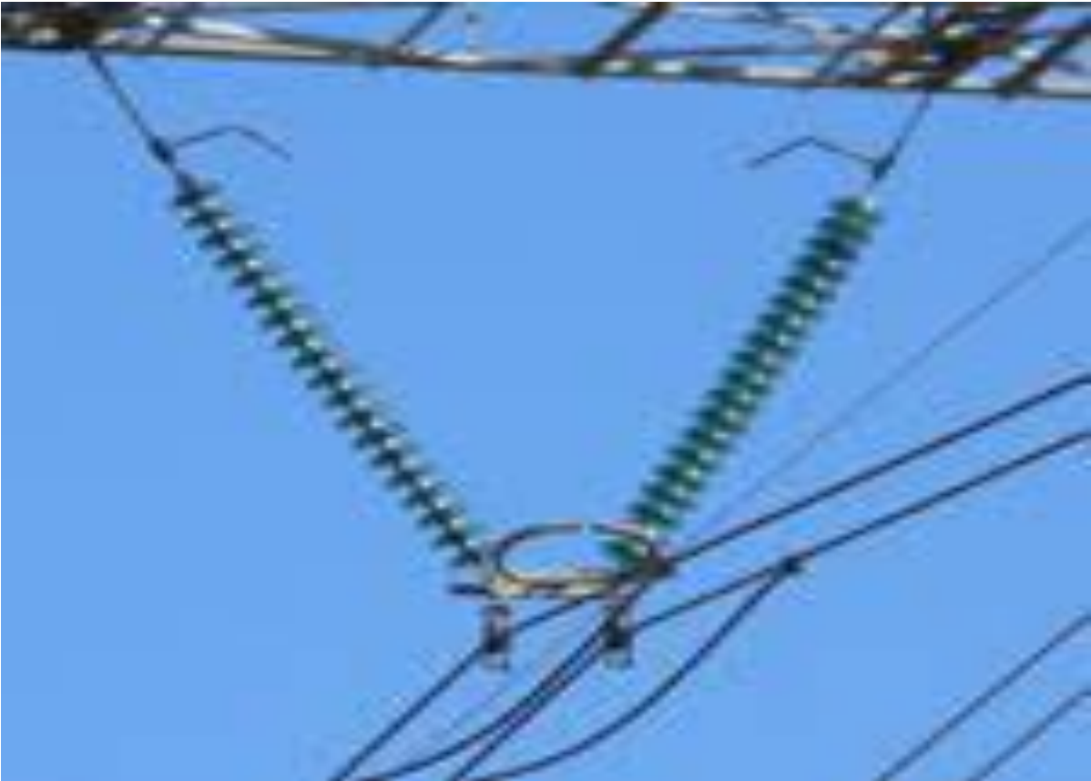
Figure II.6 : disposition inclinée des chaînes d'isolateur
