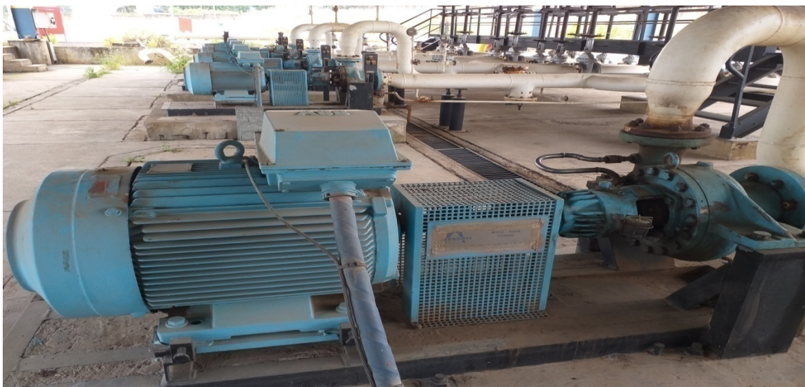
Figure I-7 : Pompes de chargement
