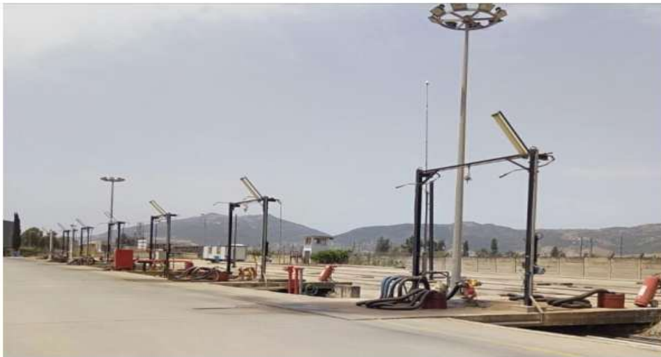
Figure I-5 : Poste de déchargement des camions (2)
