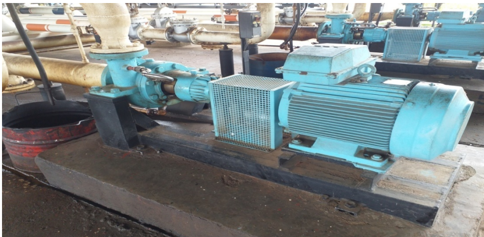
Figure I-6 : Pompes de déchargement
