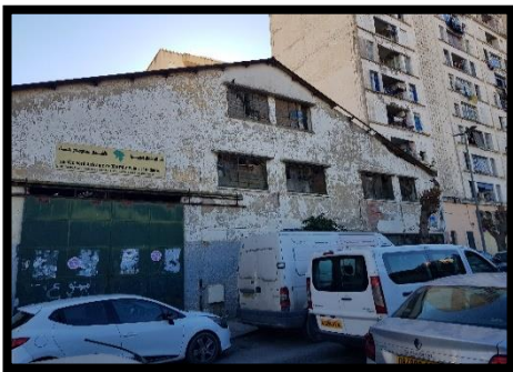
Figure 52 : Bâti mauvais état. Source : Auteurs.
