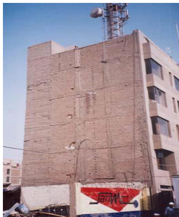
Fig. 1.16. Un exemple d'un immeuble de 5 étages en maçonnerie chaînée photographié après le tremblement de terre à Mexico City.
