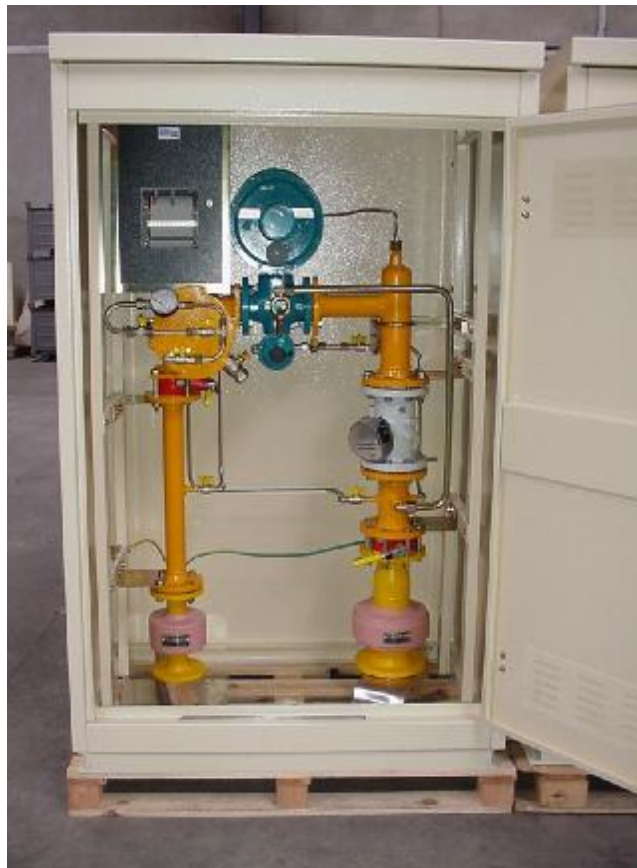
Figure II.4. Armoires de détente
