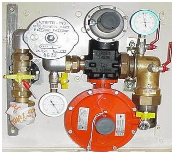
Figure. II.5. poste de détentés en coffrets
