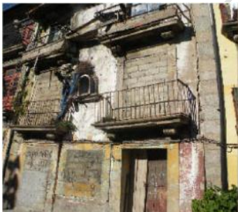
Figure 70 Logement dégradé, Sé. Source : support web
