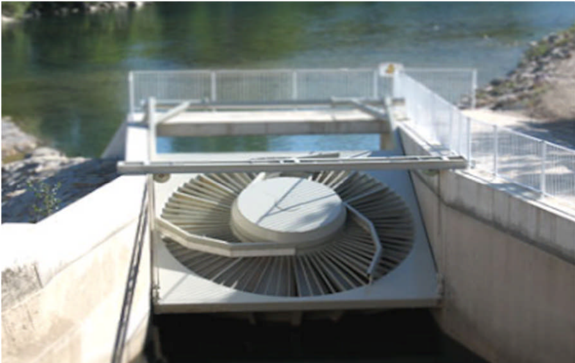
b) VLH relevée en position de maintenance
