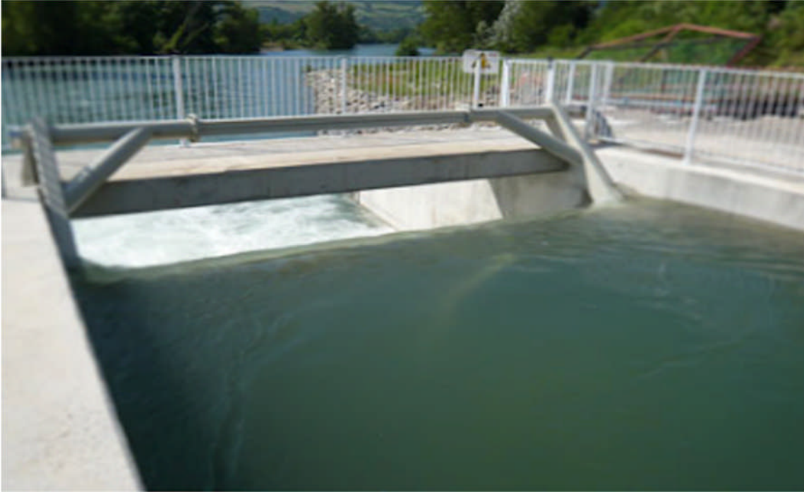
a) VLH submergée en position de fonctionnement
