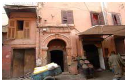
Figure 25 : façade dégradé d'une habitation
