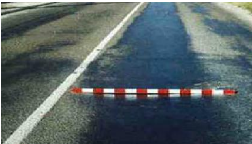
Figure 14.I. Dégradation en ressuage.
