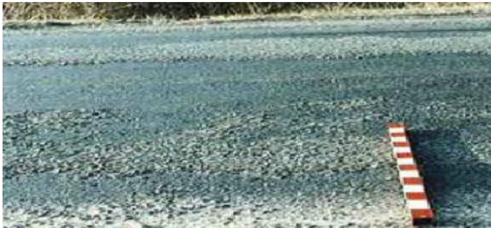
Figure 13.I. Dégradation en plumage.
