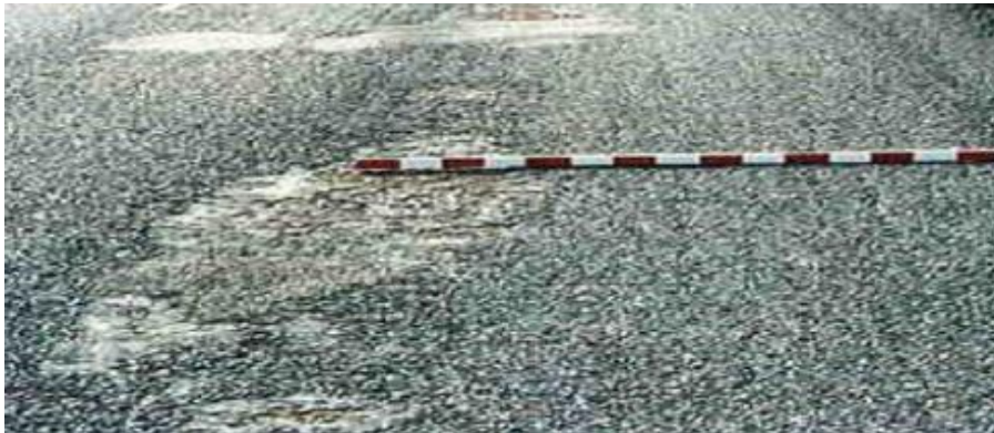
Figure 12.I. Dégradation en pelade.
