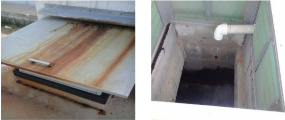
Figure 12 : Cuve de contact pour la post-chloration
