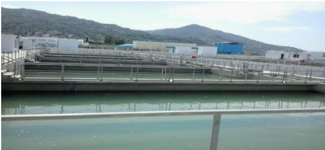
Figure 11 : Les deux filières de filtre à sable.
