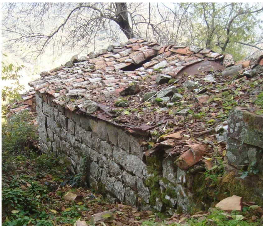
Photos 30: La dégradation de la toiture d'une maison traditionnelle kabyle du village de MOKNEA (Source : Photographie de l'Auteur)
