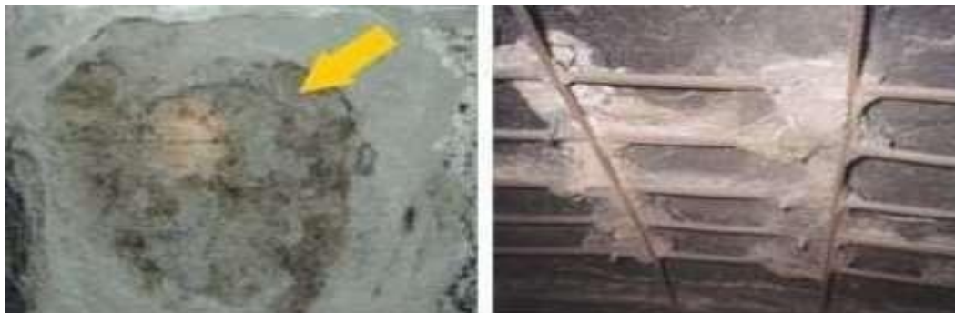
Figure II-4 : Ecaillage lors de l'incendie du tunnel mont blanc [12].
