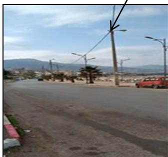
Photo 33 : tronçon en état dégradé de la RN24 Source : auteur
