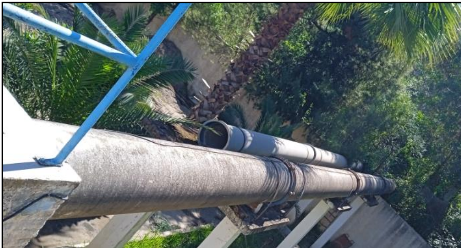
Figure 7 : Arrivée des eaux usées.
