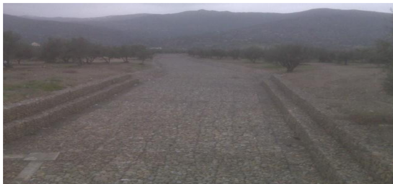
Figure 6.3 Canal en matelas Reno au fond et sur les berges.
