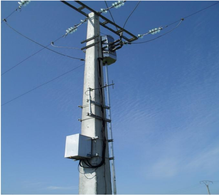
Figure II.7 : Interrupteur aérien télécommandé à creux de tension
