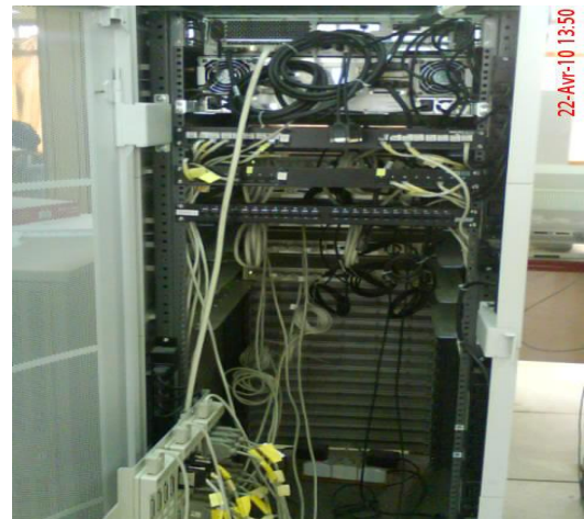
Figure I.6 : La face arrière du serveur
