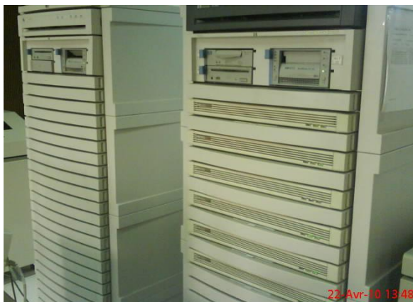
Figure I.7 : La face avant du serveur
