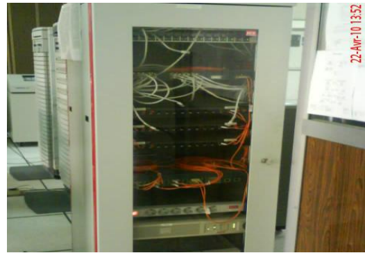
Figure I.4 : L'armoire de brassage centrale
