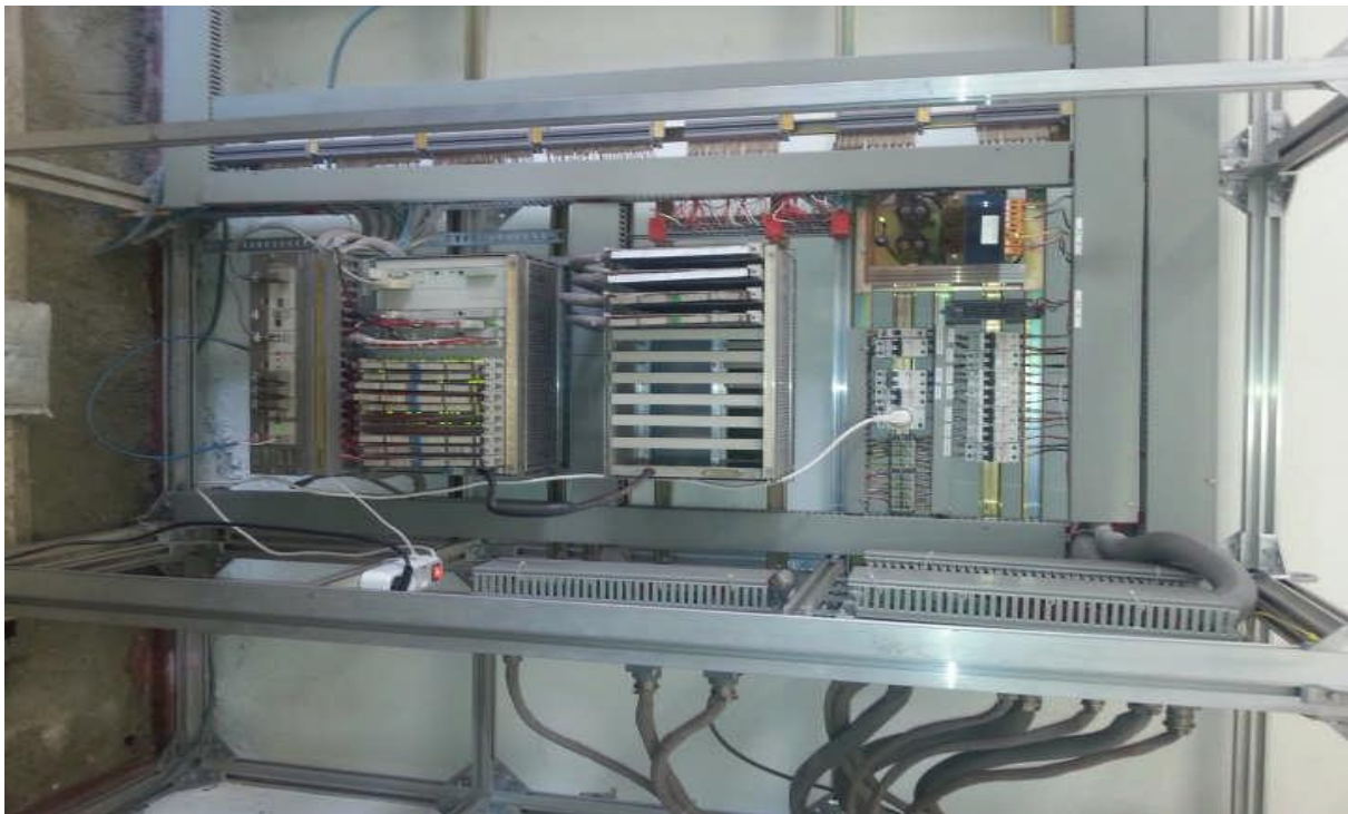
Figure I.7 : L'automate industriel S5 135U.
