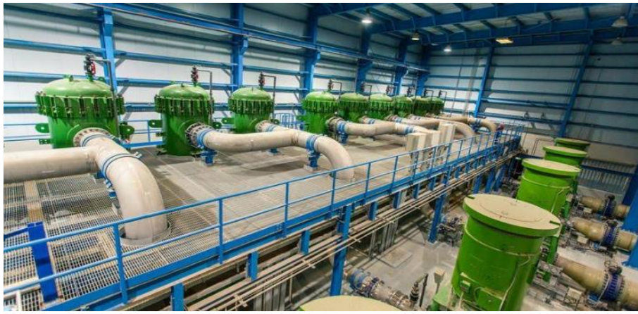
Figure I.13 : Post-traitement de l'eau de mer (Usine Al Dur, Bahreïn) [18].
