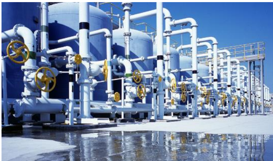
Figure I.10 : Cuves de prétraitement des eaux [18].
