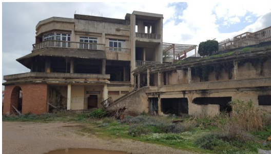
Figure 61: L'équipement dégradé. Source: Auteurs.
