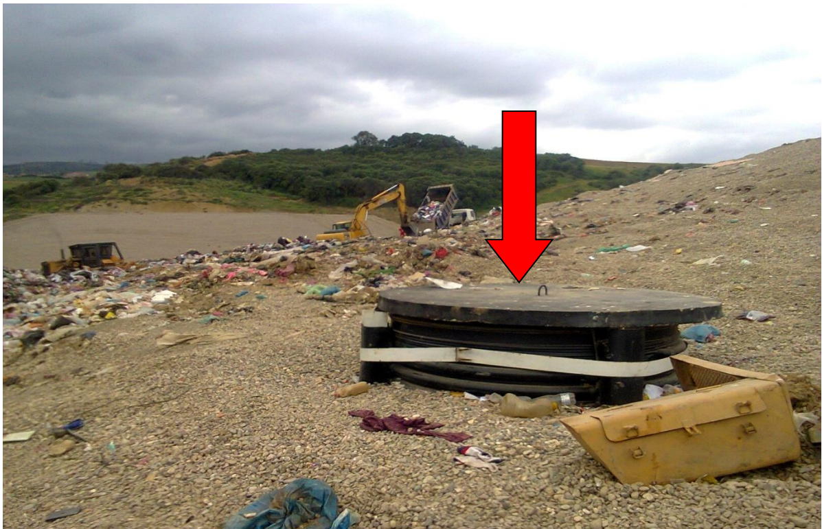
Figure I.7 : Pui de captage du biogaz.
