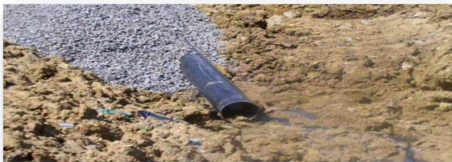
Figure I.10 : Conduite de drainage des lixiviats
