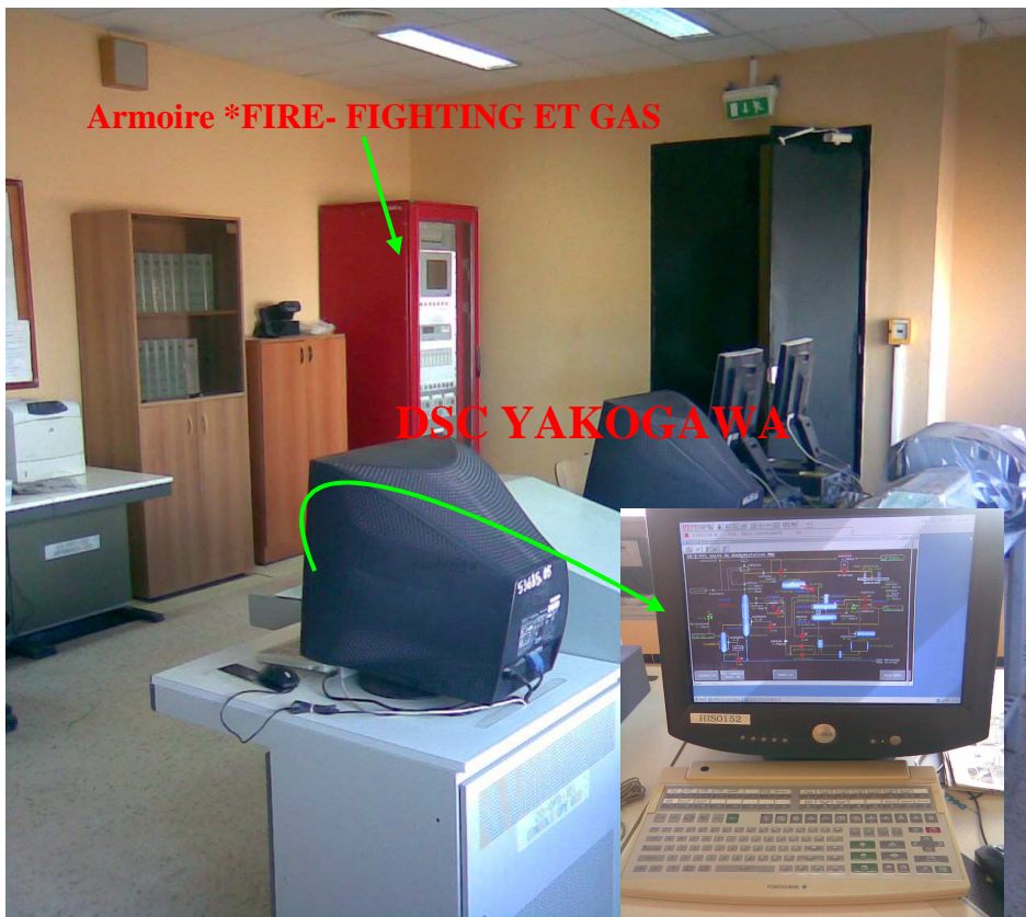
Figure. I.12. Salle de contrôle de l'unité RGTE (section compression).
