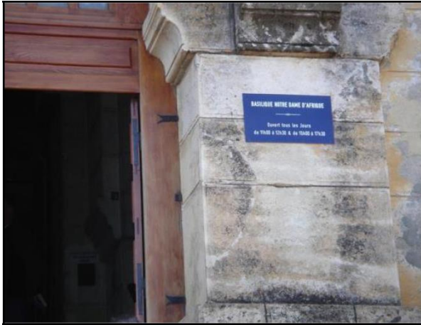
Fig 12 : Etat de la pierre de la cathédrale avant la restauration
