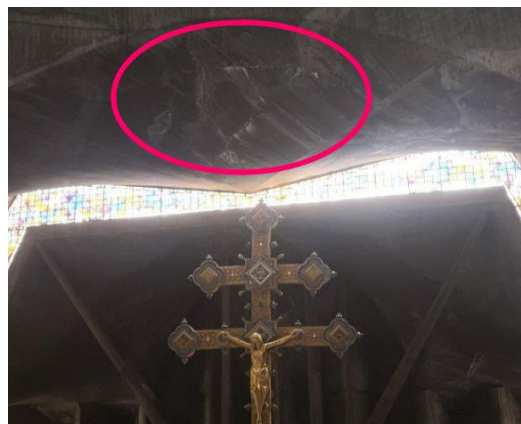
Fig 39 : Infiltrations d'eau à l'intérieur de l'église
