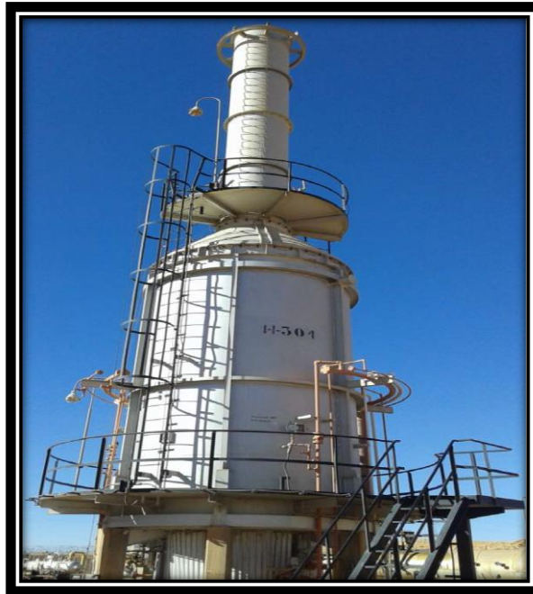
Figure 29 : Four de régénération H-301.
