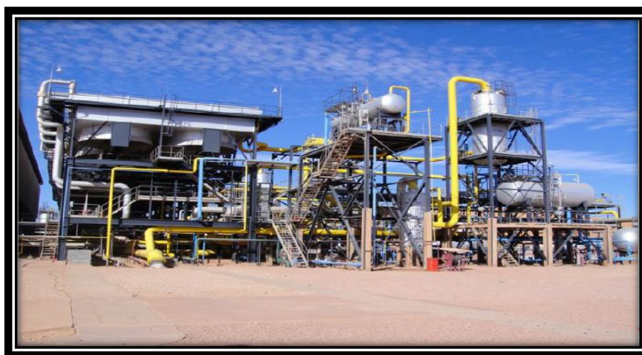
Figure 11 : Unité Fermeture Gaz Lift (FGL).
