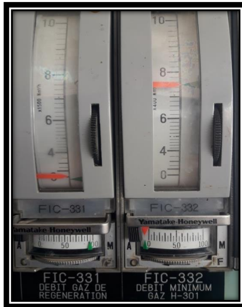
Figure 49 : Exemple de régulateurs physiques sur le panneau de contrôle.
