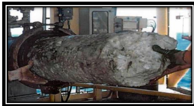
Figure 23 : Bouchage des pipes par les hydrates.
