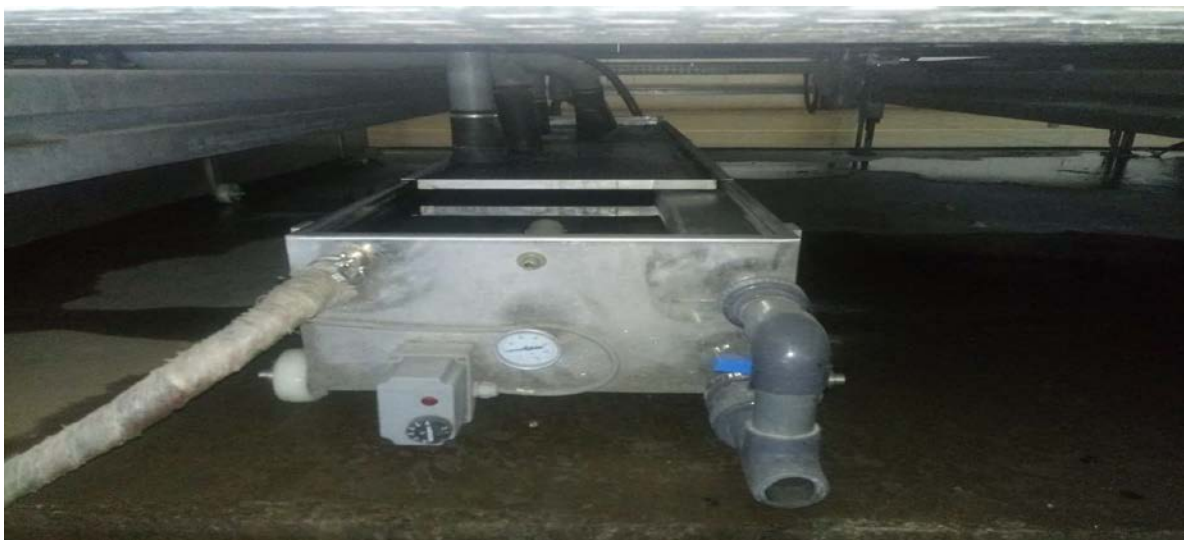
Fig.1.14 : Bac collecteur d'eau
