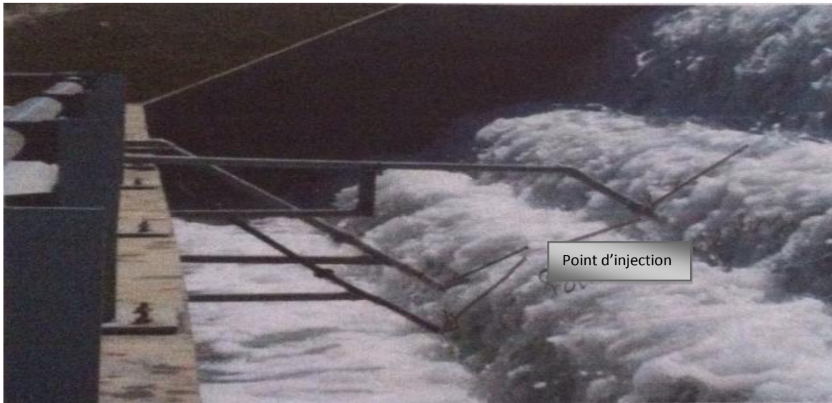
Figure I.5 : point d'injection des réactifs
